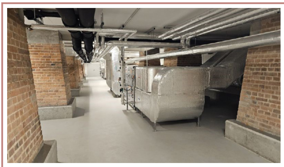
Kontrola pracy central wentylacyjnych (Źródło: UM Bydgoszcz)
