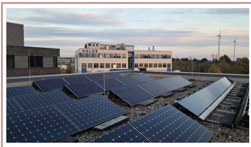
System fotowoltaiczny na dachu Centrum Technologicznego "Energy Campus Hamburg" (Źródło: PNEC)
